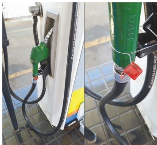
Bombas de gasolina comum e óleo diesel lacradas
